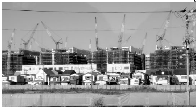
敷地面積 25 万㎡、高さ約 43m、15 棟の研究実験棟 (78500 ㎡)。 来年 1 月竣工予定
